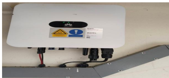
รูปที่ 3 เครื่องแปลงกระแสไฟฟ้า อินเวอร์เตอร์(Inverter) ขนาด 5 กิโลวัตต์
